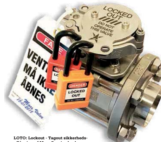
LOTO: Lockout - Tagout sikkerhedsafslåsning af Mars Service beslag. 100% sikkerhed under service og vedligeholdelse.
